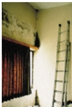
Slechte ventilatie leidt tot schimmelvorming
